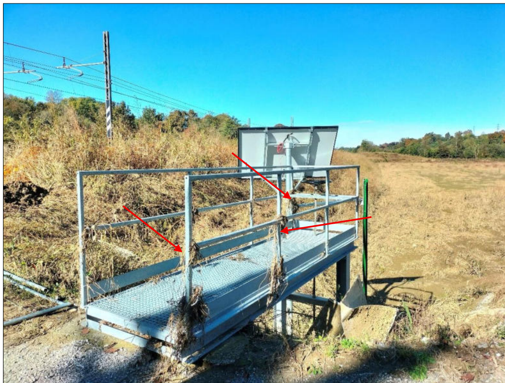
Figura 55. Manufatto di restituzione della vasca di laminazione golenale in cui si notano ancora i resti di materiale trasportato dalla corrente
