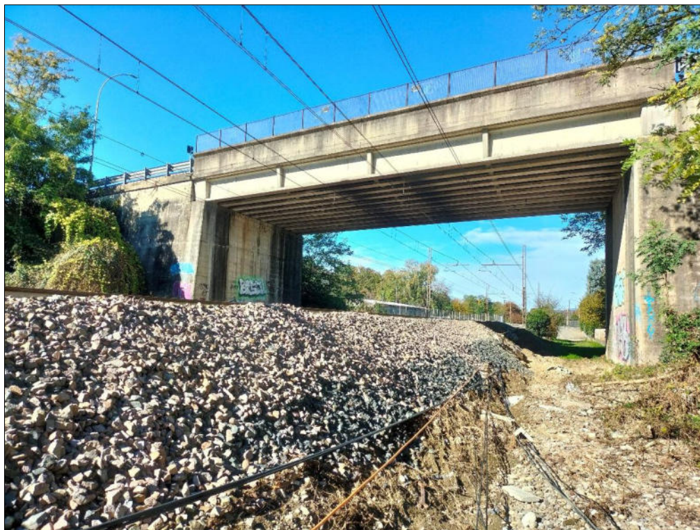
Figura 58. Sottopasso ferroviario – SP 174 dove l'acqua si è infilata provenendo da via Tintoretto (sullo sfondo); si nota l'effetto erosivo della corrente sulla massicciata ferroviaria con messa a giorno di cavi elettrici
